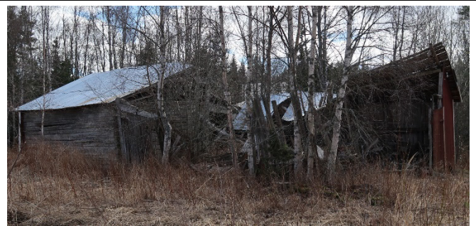
Romahtaneita piharakennuksia pihan itäosassa.
