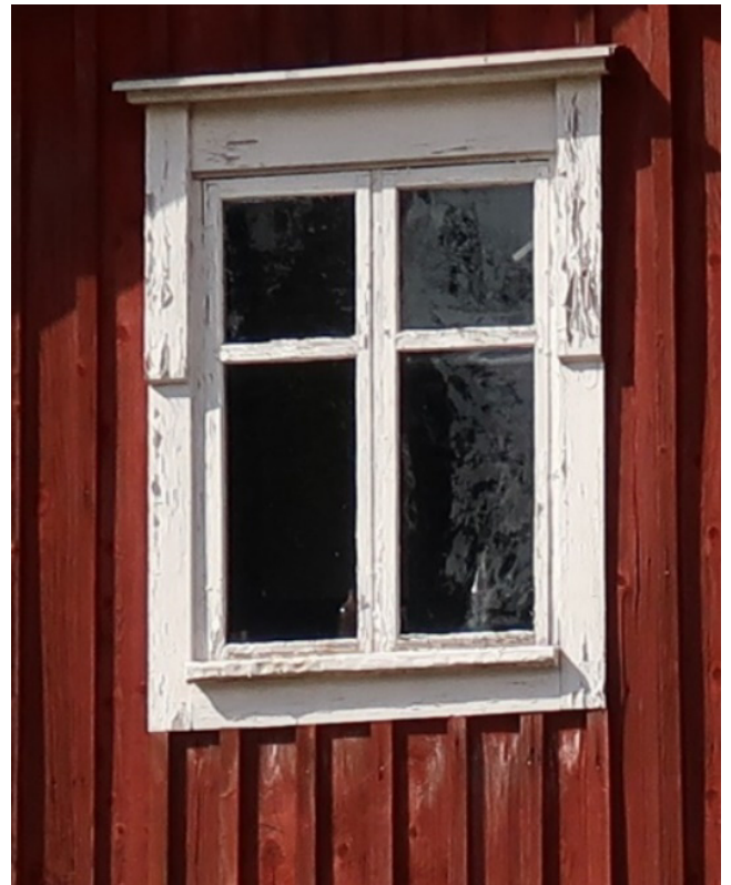
Foderbräden på fönster i första våningen.
